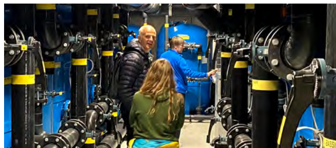
Teknikrummet i Ølstykke Svømmehal
