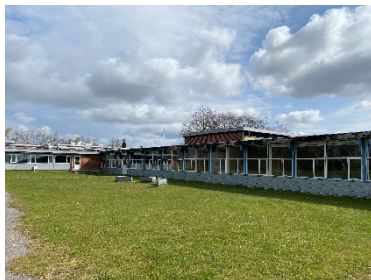
Billede 2: Der er observeret en del forskellige fugetyper ved facaderne.
