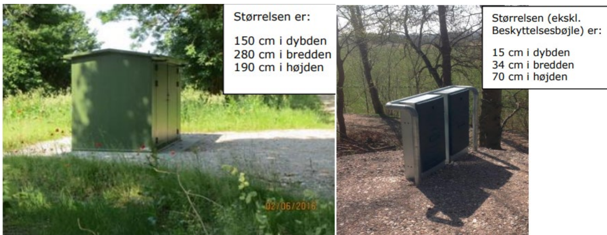
Figur 7 TV: Eksempel på et boringshus, TH: Eksempel på kabelskab med beskyttelsesbøjle
