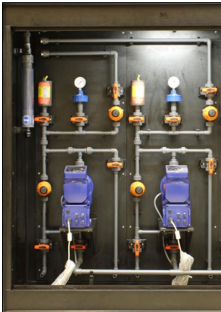
Figur 19 Præfabrikeret kabinet for doseringspumper
