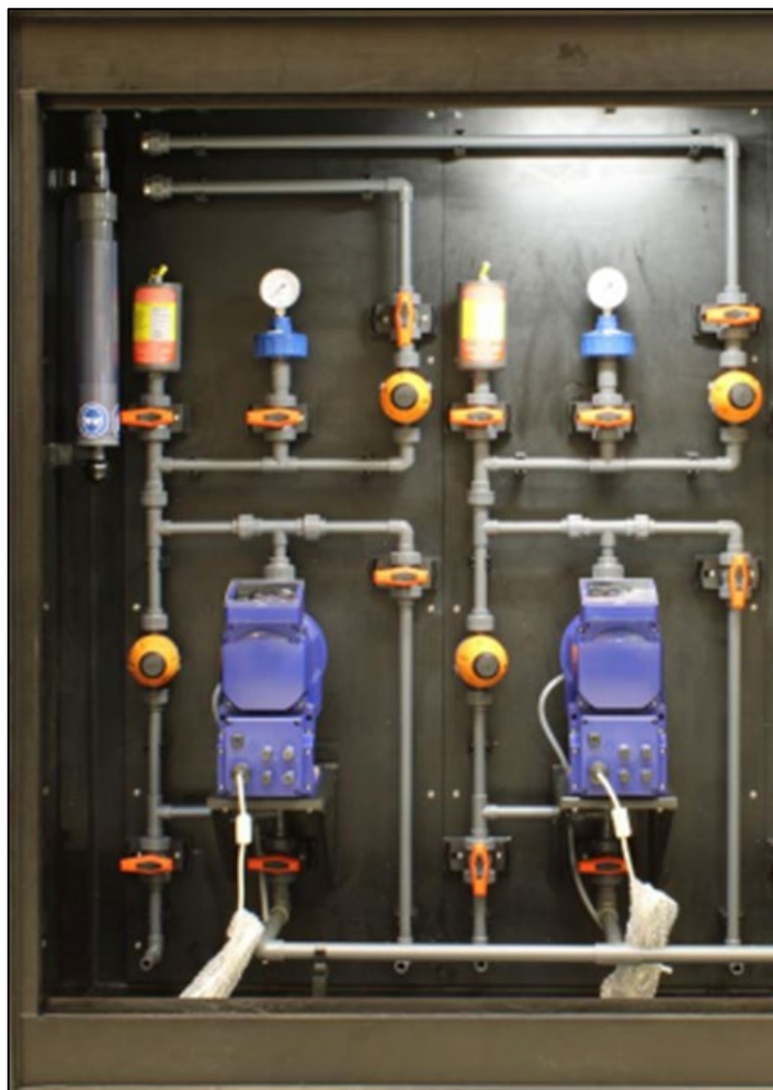
Figur 19 Præfabrikeret kabinet for doseringspumper
