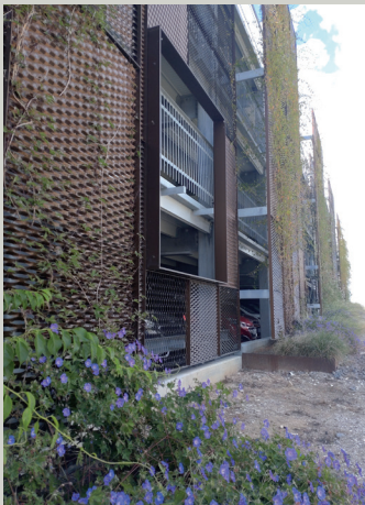
Parkeringshuset ved siden af Føtex med facader i strækmetal så der kan klatre planter op ad facaden
